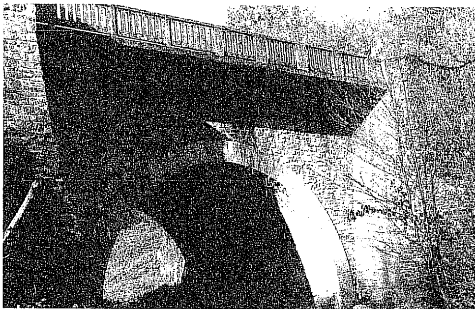
Vue du pont, côté amont. La vue page 107 est prise côté aval.
