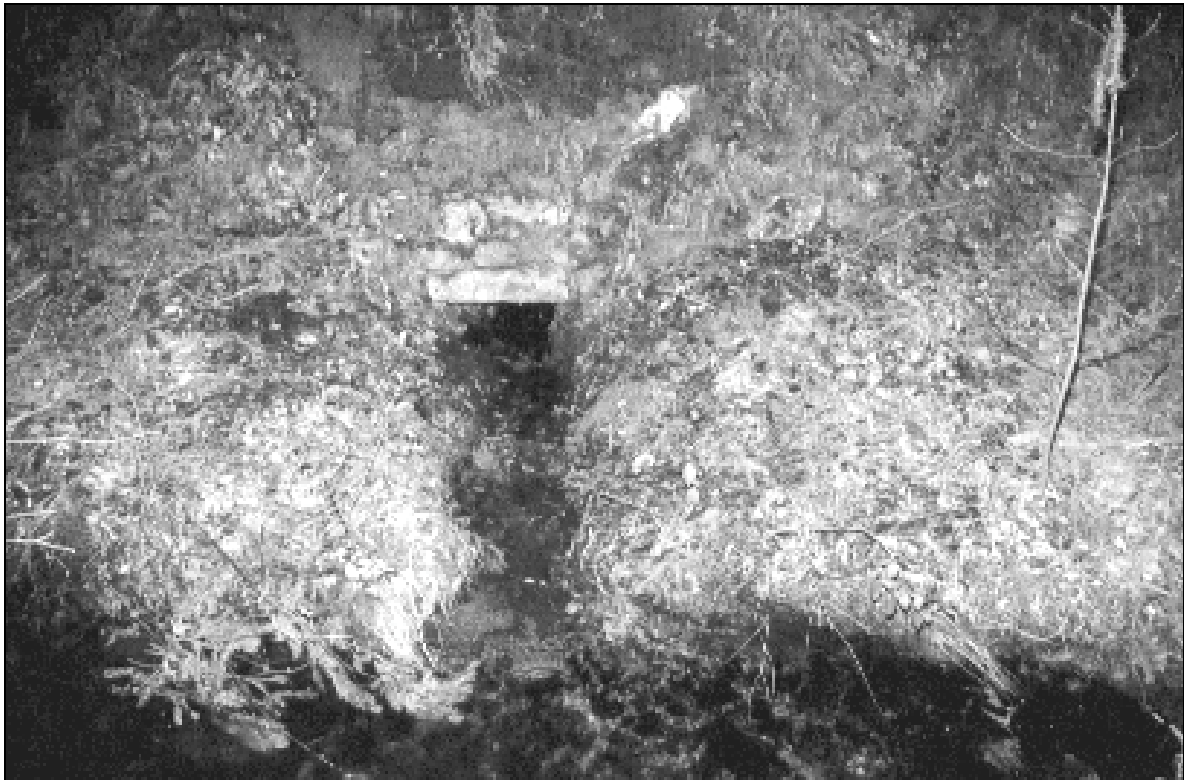
Moulin de St-Priest les Vergnes : sortie de la voûte, l'eau se trouve difficilement un chemin pour rejoindre le ruisseau des Vergnes
