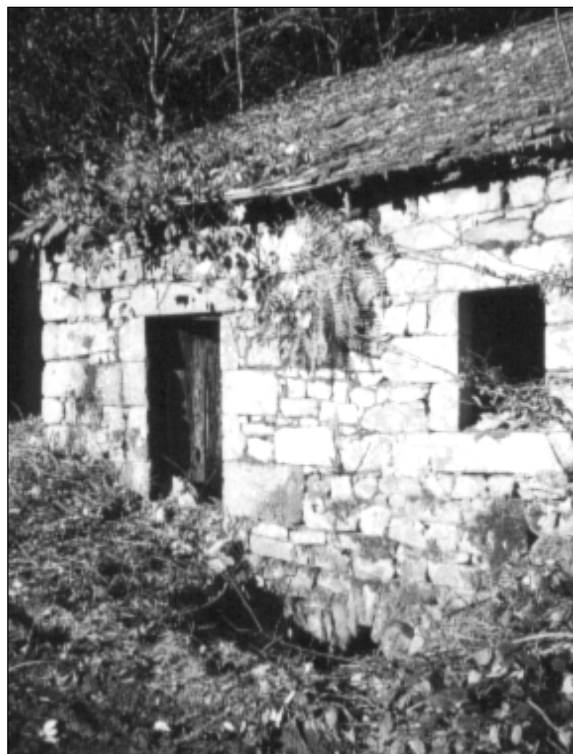
Moulin de Courtiaux Romanet : on remarque, en bas du mur de façade, à droite de la porte, la voûte de pierres sous laquelle ressortait l'eau du canal de dérivation
